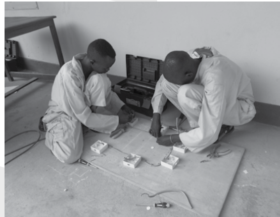
Študenti zapájajú elektrický obvod vrátane vypínačov a zásuviek, foto: Norbert Demmelbauer, 2016
